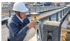
①③GNSS測量機(点名:)
